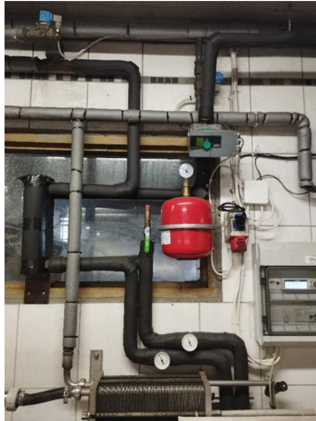
Mustat putket ovat talviaikaisen jäähdytysjärjestelmän
