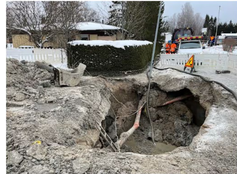
Putkirikko pyritään korjaamaan mahdollisimman pian. Kuva: Kalle Pallonen / Yle
