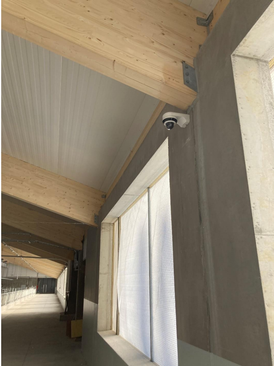
Kuva 4 Eläinhallin seinällä oleva kamera-asennus
